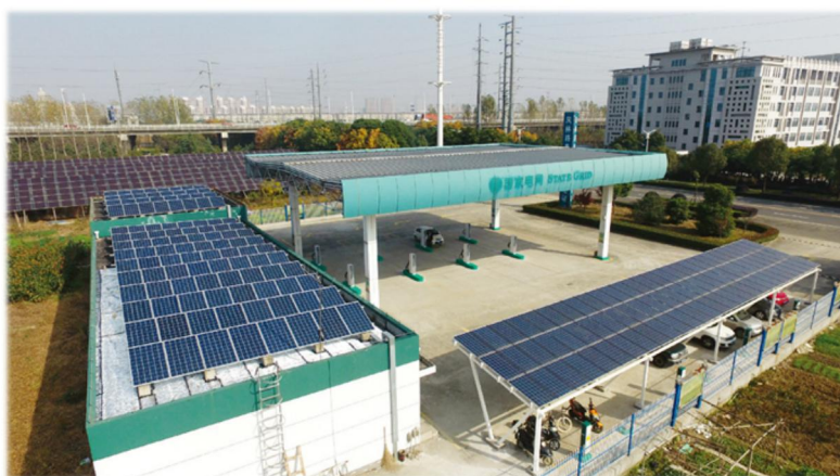
图 7-2 光储充一体化充电站
